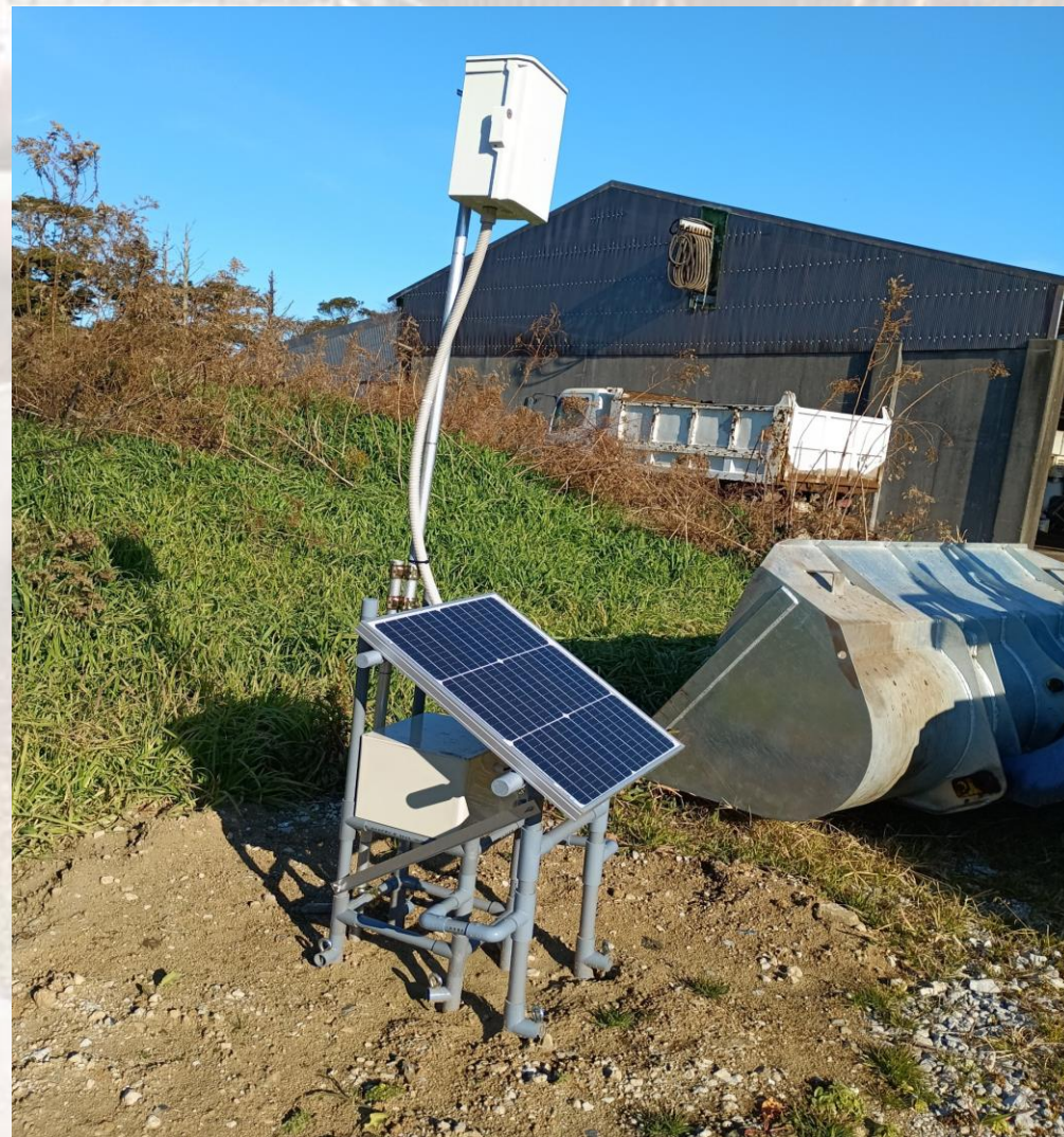
農場内ファーム基地局設置写真（正面）
